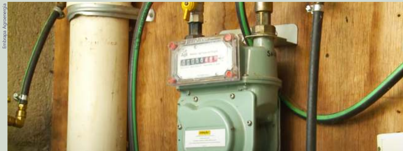
Medidor de gás de um biodigestor
